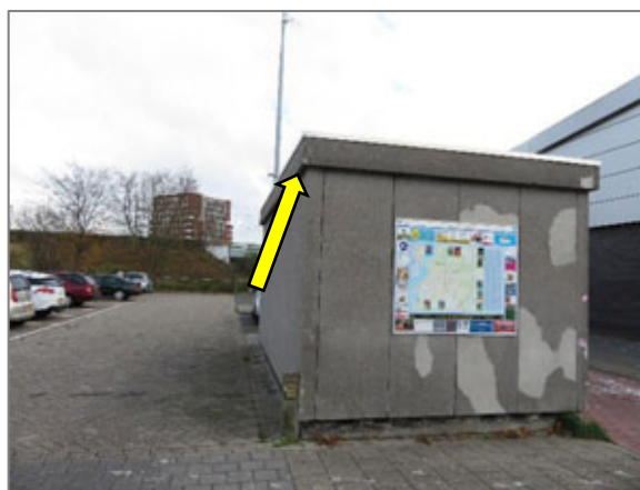
Afbeelding 5.2 Locatie van de gewone dwergvleermuis in het te behouden transformatorhuisje. Dit bevindt zich buiten het plangebied.
